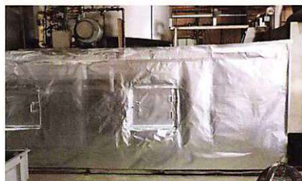
乾燥炉、作業員の環境改善と省エネ対策に!
